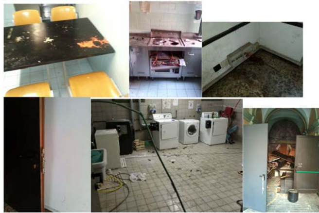
Figura 47: Stato del degrado pervenuto dopo lo sgombero della residenza
